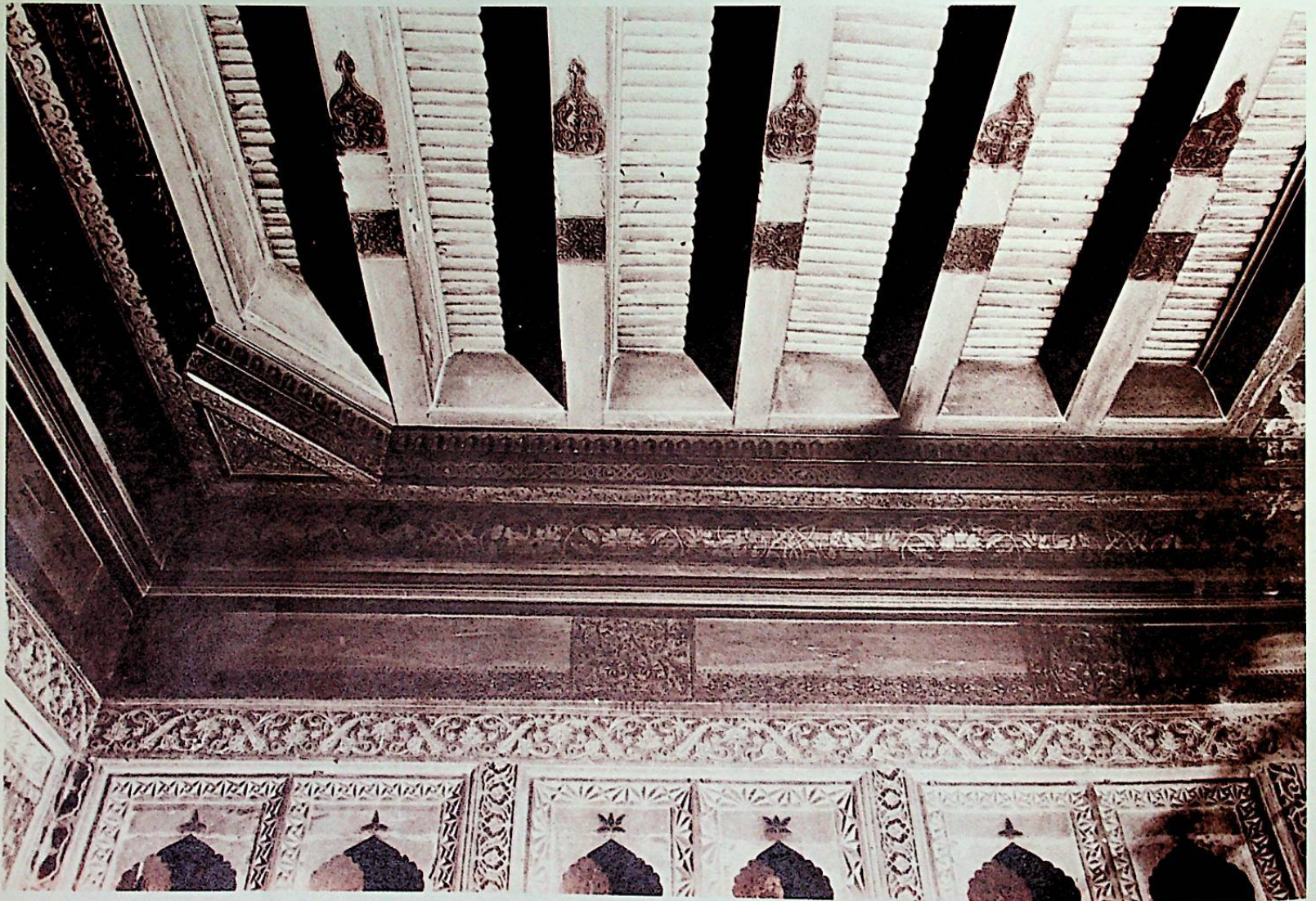
排椽式天花板 (位于喀什市安吉延街, 约建于公元1875年) A raftered ceiling built around 1875 in Anjan Road, Kaxgar.
