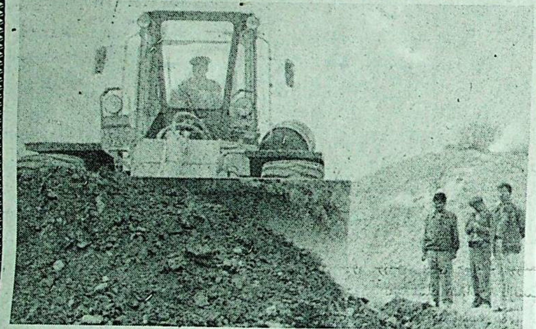
ئانۇش تاشيول ئۇچاستىسى بۇ يىل 3 - ئايدىن بۇيان كۈچى مەركەزلەشتۈرۈپ قەشقەر - تورغات چېگرا تاشيولىنىڭ بۇزۇلغان بۆلەكلىرىنى رېمونت قىلىپ، چېگرا تاشيولىنىڭ راۋانلىقىغا كاپالەتلىك قىلدى. سۈرەتتە: ئۇچاستىغا رەھبەرلىرى تاشيولدىكى توسالغۇلارنى تازىلاشقا قوماندا نلىق قىلىقتا. يالقۇن قادىر فوتوسى
